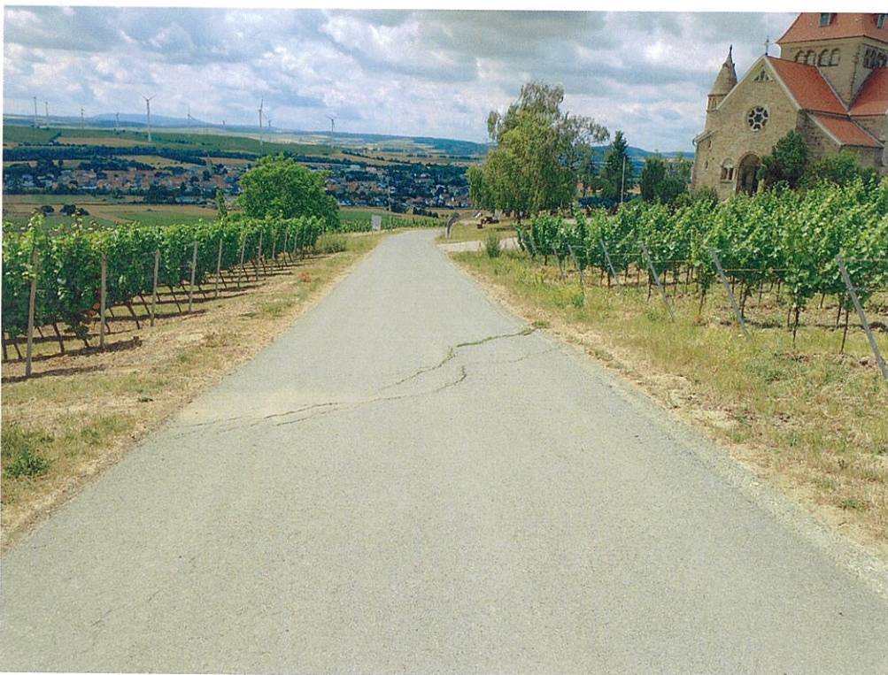
Bild 10: Abschnitt 4, Blick Richtung Westen, Schadstelle durch Hangrutsch
