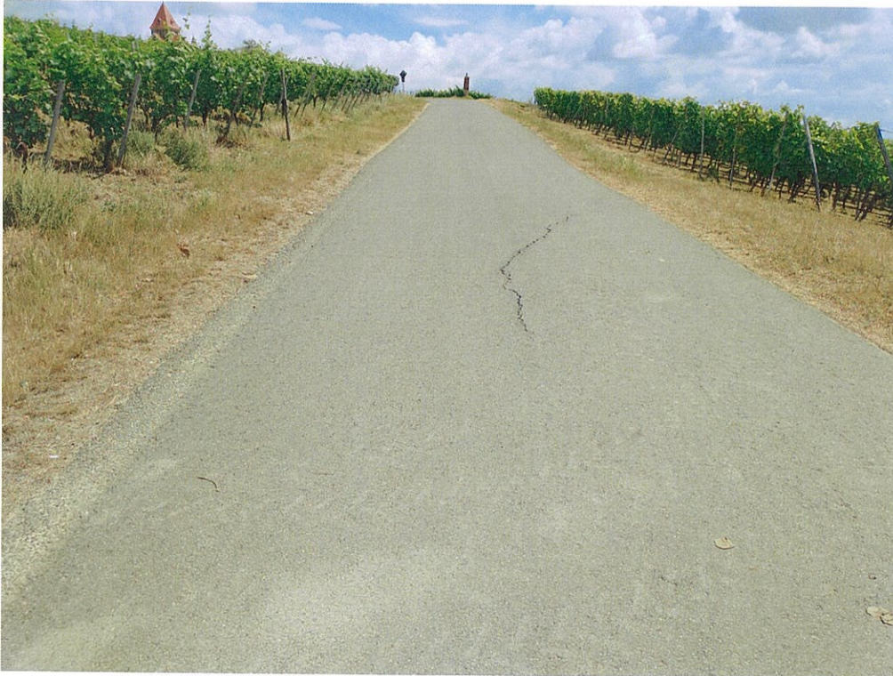
Bild 9: Abschnitt 4, Blick Richtung Osten, Schadstelle mit Riss
